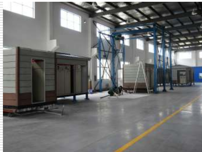
↑ 箱式变电站车间
